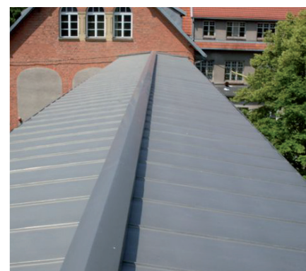
Fot. 9. Przykład kalenicy wentylacyjnej
